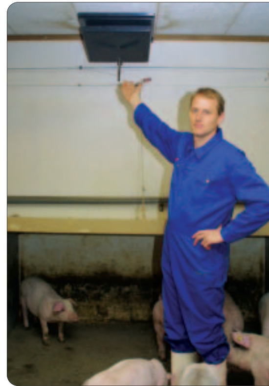
Poul Goul Jensen ved den nye loftventil, som giver meget luft i stalden og fungerer som nødventilation.
