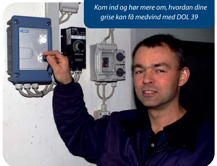
Poul Skøtt drejer på nøglen, og så kører ventilatoren med modsat rotation, og dermed får grisene medvind i udleveringsrummet. Foto. Knud Erik Riis.
