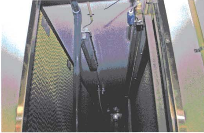
Papirfiltrene skylles automatisk med en vandventil, der er ophængt overfor filtrene, og som systematisk skyller over hele overfladen på filtrene, så udtørring undgås.
