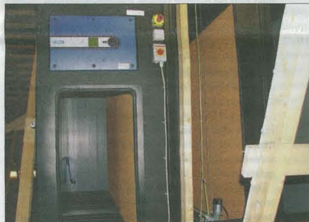
BIO 2: Anlægget består af to filtre, der overrisles med vand. (Foto: Camilla Bønløkke)
