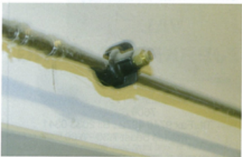
Højtryksdysse på væggen.
