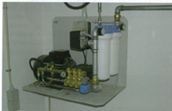
Kompressoren til højtrykskøleanlægget.
